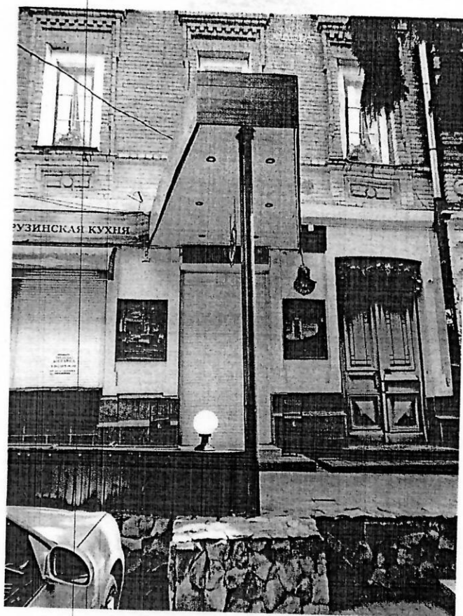
Фото 2. Объект культурного наследия регионального значения «Особняк», конец XIX в., расположен по адресу (местонахождение): Ставропольский край, г. Пятигорск, улица Дзержинского, 41. Диссонирующая отделка части главного фасада.
